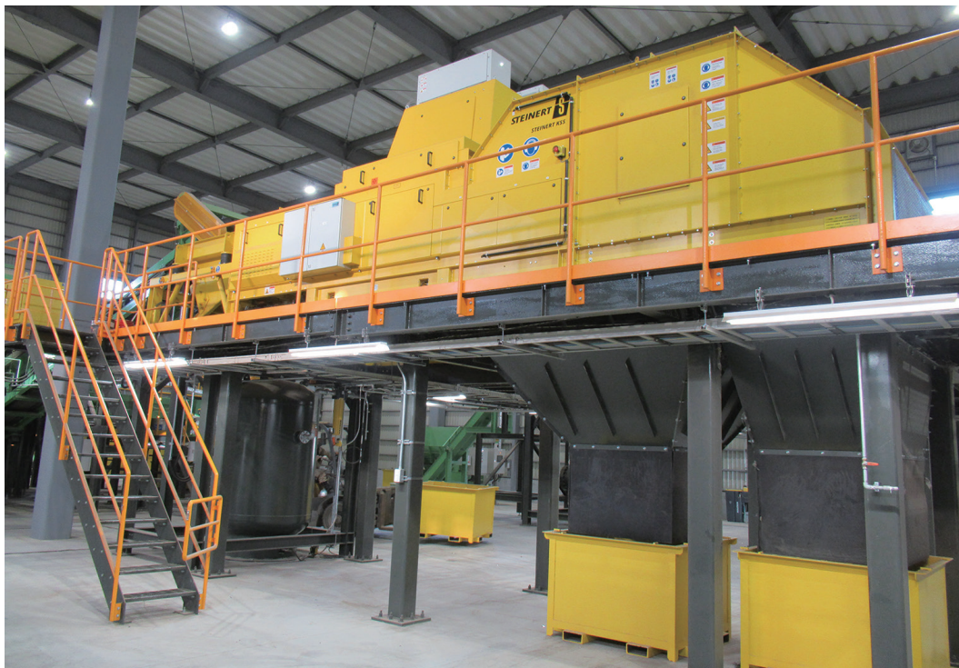
選別棟に2台備わるシュタイナート製「KSSコンビネーションソーター」
